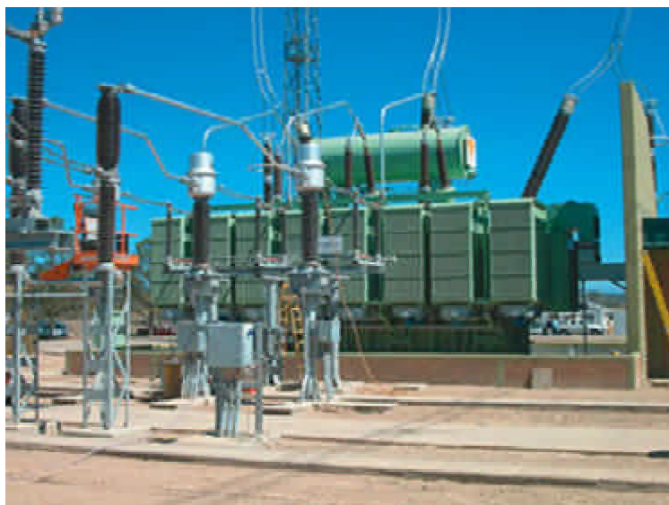
Transformador que se encuentra actualmente en la ET Arroyo Cabral.
